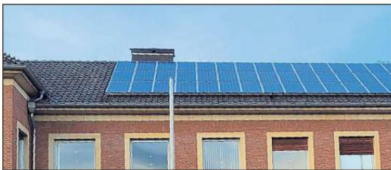
Auf einigen kommunalen Dächern befinden sich Solaranlagen, die aber noch keinen Strom liefern. Jetzt hat die Verwaltung noch einmal erklärt, warum das so ist. Archivfoto: Aundrup
