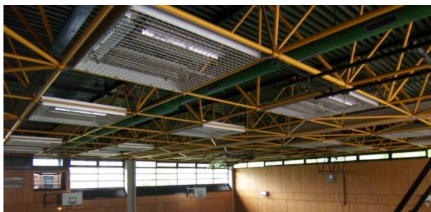
Abbildung 17 - Sporthalle Berufskolleg Ahlen Beleuchtung (Leuchtstoffröhren) vor Umrüstung
