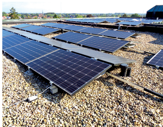
Photovoltaikanlage auf dem Kreishaus
