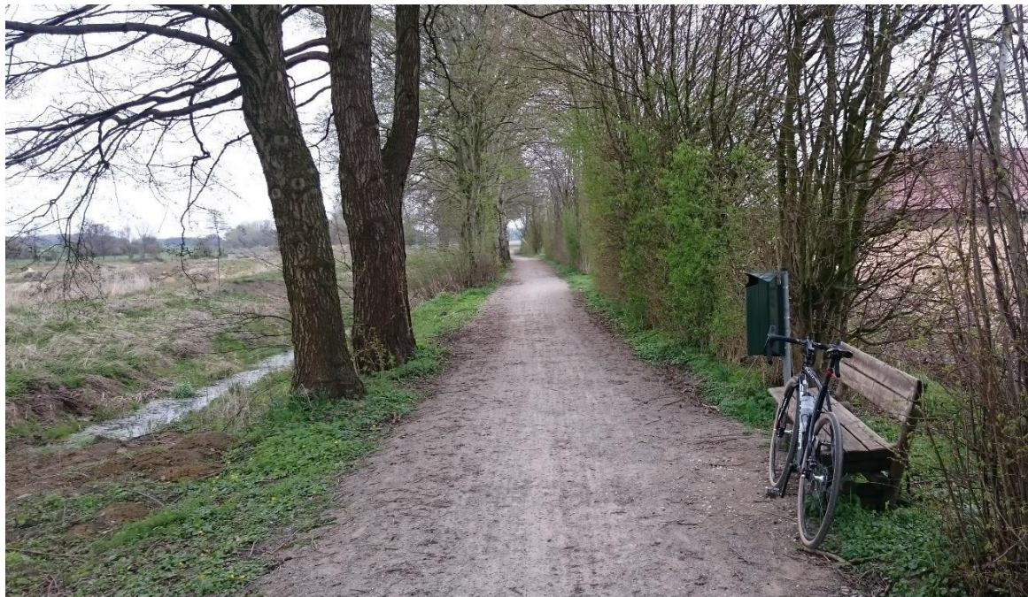
Abbildung 26: Wassergebundener Weg außerorts mit ausgefahrener Oberfläche
