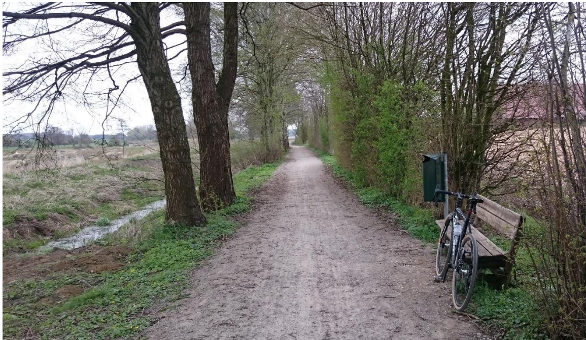
Abbildung 26: Wassergebundener Weg außerorts mit ausgefahrener Oberfläche
