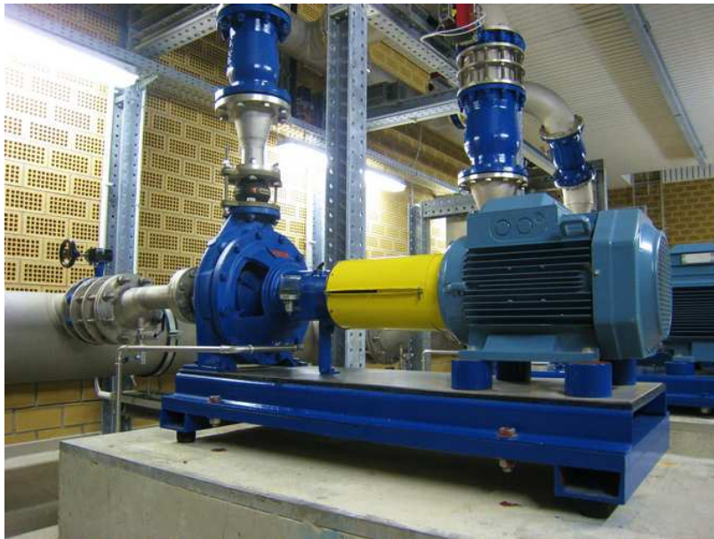
Bildquelle: Gesundheitsamt Kreis Warendorf: Reinwasserpumpe der Stadtwerke Warendorf GmbH
